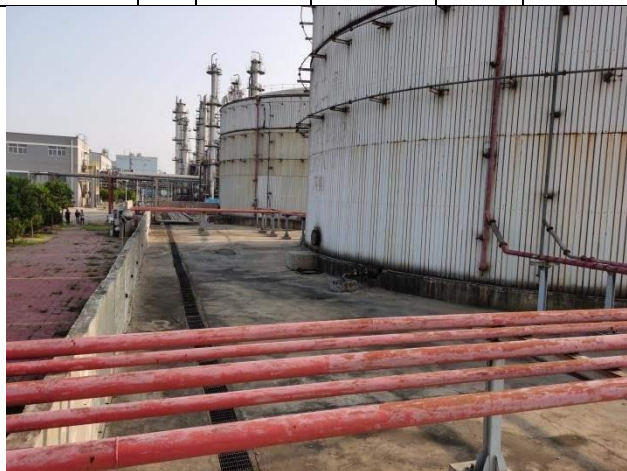
乙二醇成品副产品罐区
